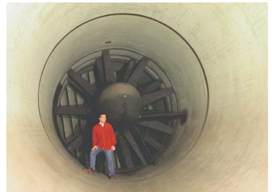
Figuur 2: Zicht op de aandrijfventilator van de L1 windtunnel (500kW).
