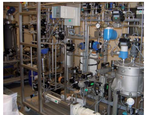
Industriële pilotinstallatie voor verregaande zuivering van afvalwater door middel van membranen
